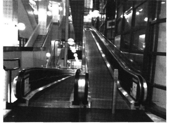
図3 歩行者用電動スロープ 外来棟フロアが全て結ばれている。
